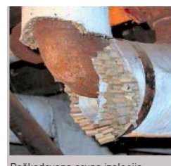
Poškodovana cevna izolacija
