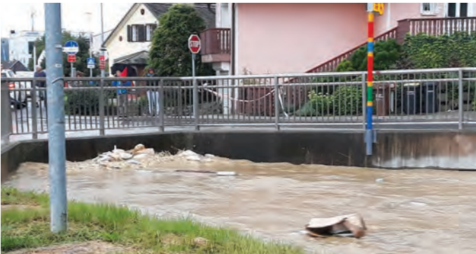
Gregčev most na Ljubljanski cesti na vrhuncu poplavnega vala
